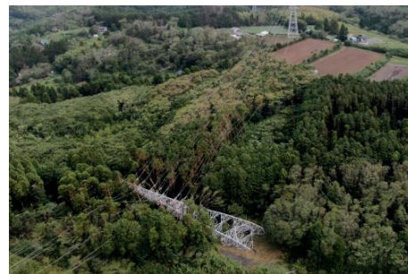
千葉県君津市送電線鉄塔倒壊 (2019年9月台風)
