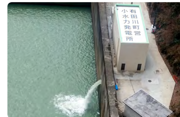
有田川町菅一川小水力発電所 和歌山県有田郡 写真協力: 有田川町役場
