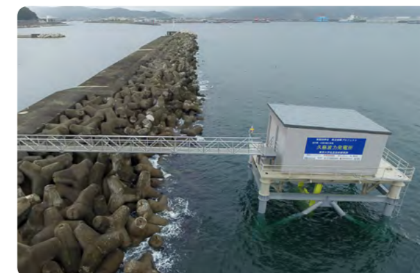
久慈波力発電所 (若手島久慈市) 写真協力: 東京大学生産技術研究所
