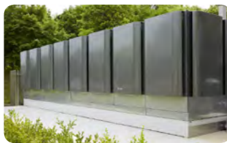
出力200kWの大型燃料電池システム (慶應義塾大学湘南藤沢キャンパス)
