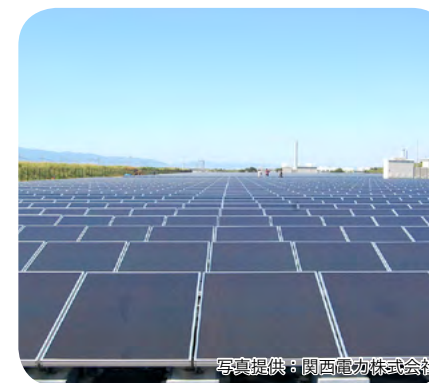
たくさんの太陽光パネルをならべたメガソーラー「堺太陽光発電所」（大阪府堺市）
