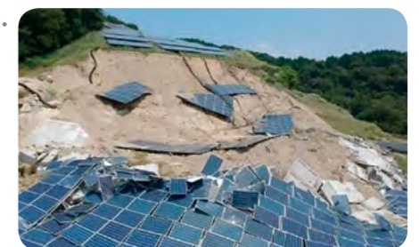
台風の風雨でこわれた太陽光パネル
