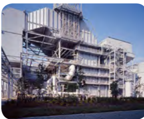
▲排煙脱硫装置
