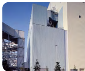
▲排煙脱硝装置
