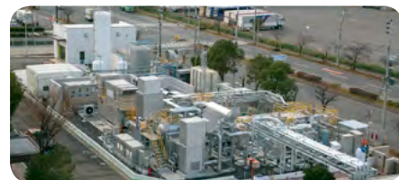
水素100%による電気・熱供給 (兵庫県神戸ポートアイランド)
