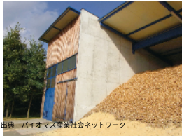
木質チップによる小規模地域熱供給施設
