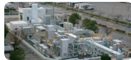
水素100%による電気・熱供給 (兵庫県神戸ポートアイランド) 2018年、水素燃料100%のガスタービン発電による電気と熱の供給を世界で初めて市街地でおこなった。電力や熱は近隣の病院などの施設へ供給されている。
