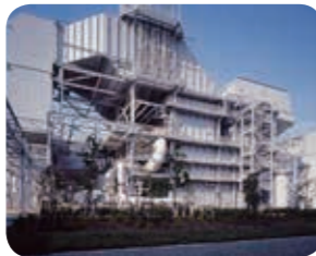
▲排煙脱硫装置
