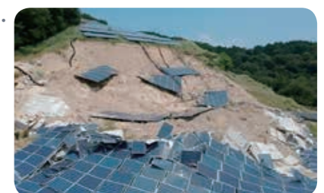
台風の風雨でこわれた太陽光パネル
