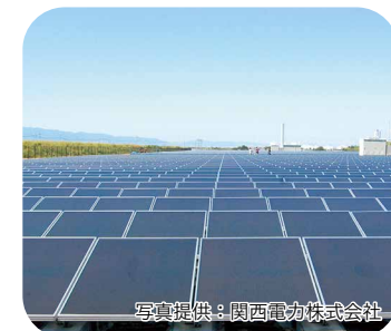
たくさんの太陽光パネルをならべたメガソーラー「堺太陽光発電所」(大阪府堺市) 写真提供:関西電力株式会社
