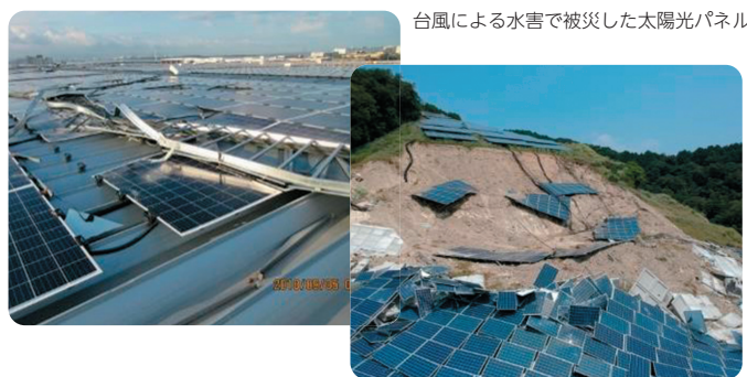
台風による水害で被災した太陽光パネル
