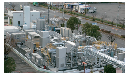
神戸市にある水素発電所
